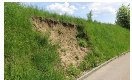
Offene Kante am Strassenrand. (Oteltingen)
